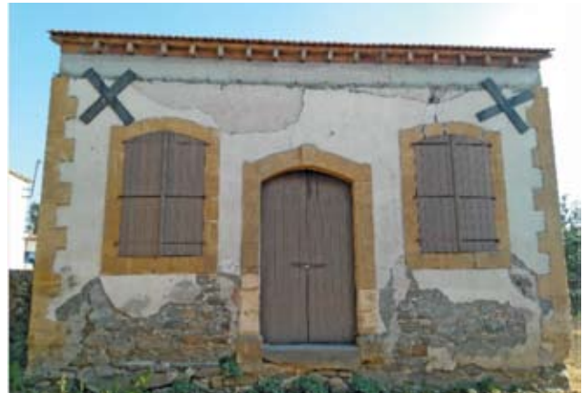
Εικόνα 2 Υφιστάμενη κατάσταση του τζαμιού πριν την αποκατάσταση
