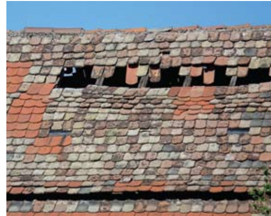
Η συχνότερη μορφή αστοχίας υπό ανεμοφόρτιση είναι η απώλεια της επικάλυψης της στέγης, καθώς και οι βλάβες στο φέροντα οργανισμό της στέγης
