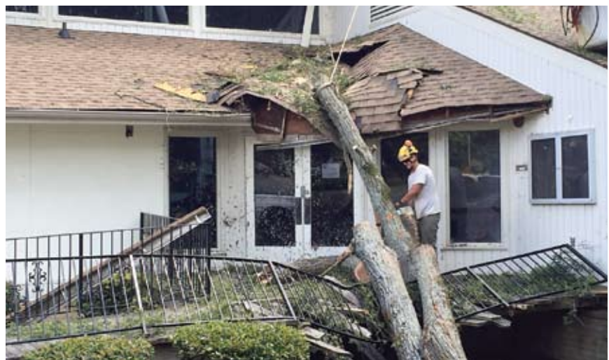
Σε αρκετές περιπτώσεις, ορθώς κατασκευασμένα κτίρια προσβάλλονται λόγω ανέμου από το περιβάλλον τους. Οι βλάβες δεν εμφανίζονται αμέσως λόγω ανεμοπίεσης, αλλά προκαλούνται λόγω αστοχίας γειτονικών κτισμάτων, δέντρων, στύλων ηλεκτροδότησης και λοιπών στοιχείων.
