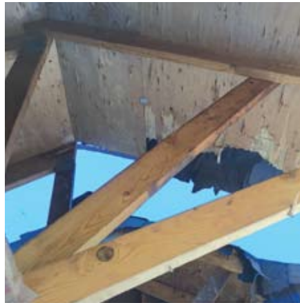
Η διαφορά ανεμοπίεσης ανάμεσα στην εξωτερική και στην εσωτερική πλευρά της στέγης οδηγεί σε απώλεια των επικαλύψεων.
