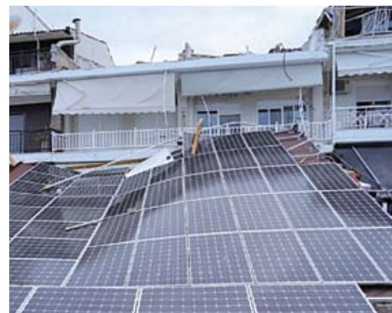
Αστοχία δομικού χαρακτήρα (στέγατρο), καθώς και του συστήματος φωτοβολταϊκών, λόγω ισχυρής ανεμοπίεσης.
