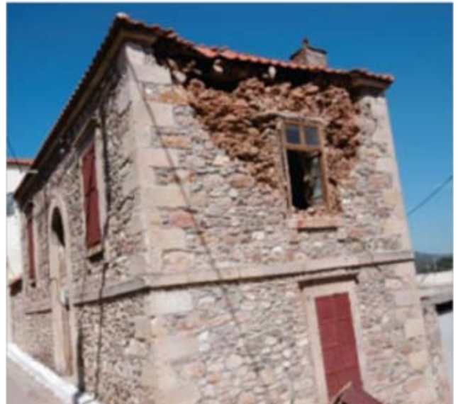
Σχήμα 3.: Τραπεζοειδούς σχήματος αστοχία εξωτερικής στρώσης τοιχοποιίας.
