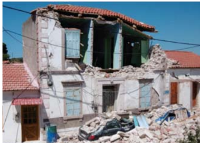
Σχήμα 2.: Κατάρρευση πλευρικού τοίχου σε ανισοσταθμία (δεξιά) και ανατροπή τοίχου της όψης λόγω ανεπαρκούς σύνδεσής του με εγκάρσιους τοίχους και απουσίας διαζώματος στην οροφή του ορόφου.
