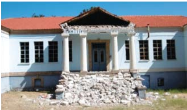
Σχήμα 1.: Αποκόλληση και πτώση τιμπάνου αετώματος λόγω σεισμού στην είσοδο δημοτικού σχολείου.
