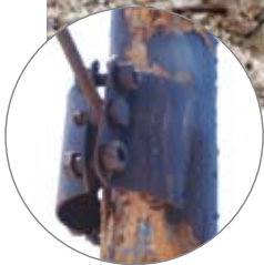
Σχήμα 12: Έντονη διάβρωση σε βαθμό πλήρους διάλυσης τμημάτων δομικών μελών
