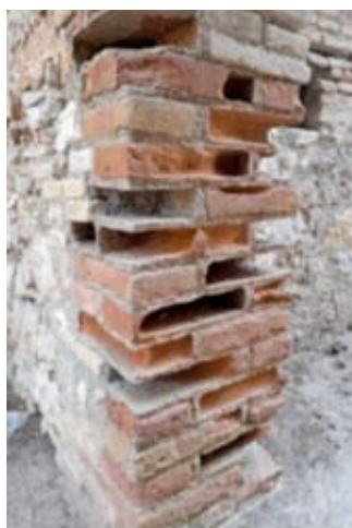
Εικόνα 1 – Τοιχοποιία από οπτόπλινθους και τσιμεντοειδές κονιάμα, όπου τα λιθοσώματα έχουν διαβρωθεί, ενώ ο αρμός παραμένει.
