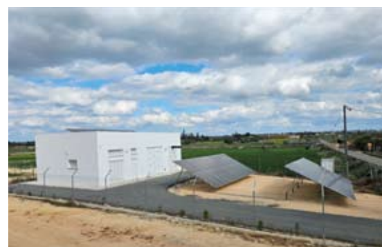
Αντλιοστάσιο Μεταφοράς Λυμάτων με φωτοβολταϊκά
