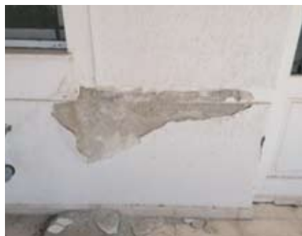
Εικόνα 2: Αποκόλληση επιχρίσματος μπογιάς
