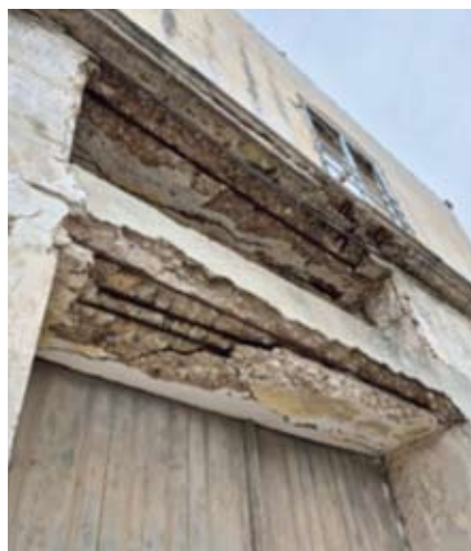
Εικόνα 4: Έντονη αποσάθρωση και αποκόλληση επικάλυψης σκυροδέματος, ενανθράκωση σκυροδέματος και αποκάλυψη / οξείδωση / διάβρωση και απομείωση διατομής οπλισμού
