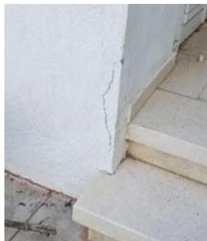
Εικόνα 3: Ρηγμάτωση μικρού εύρους και μήκους σκυροδέματος/επιχρίσματος
